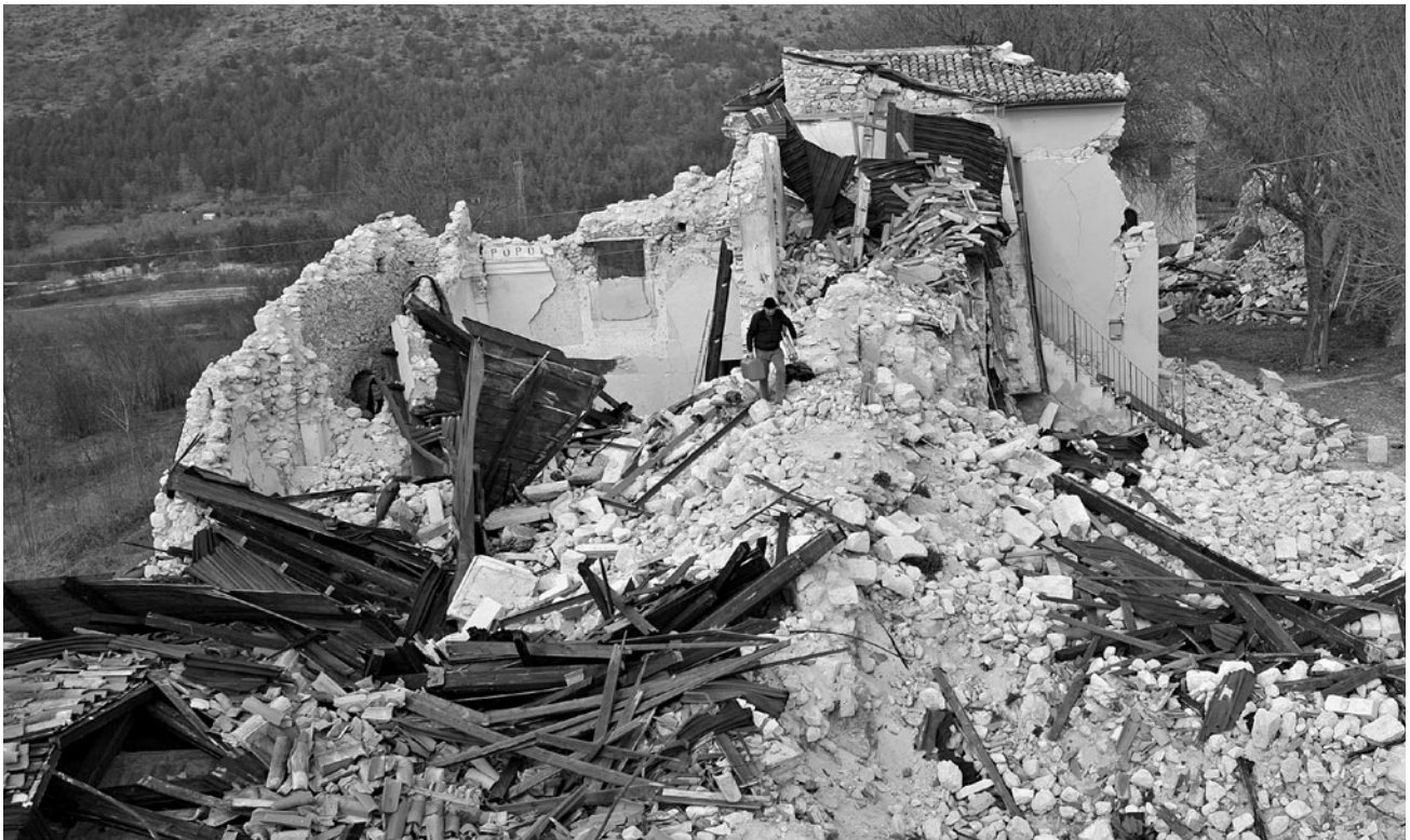
fig. 9 – La chiesa dei S. Stefano e Silvestro a Castelnuovo di San Pio delle Camere dopo il sisma.
