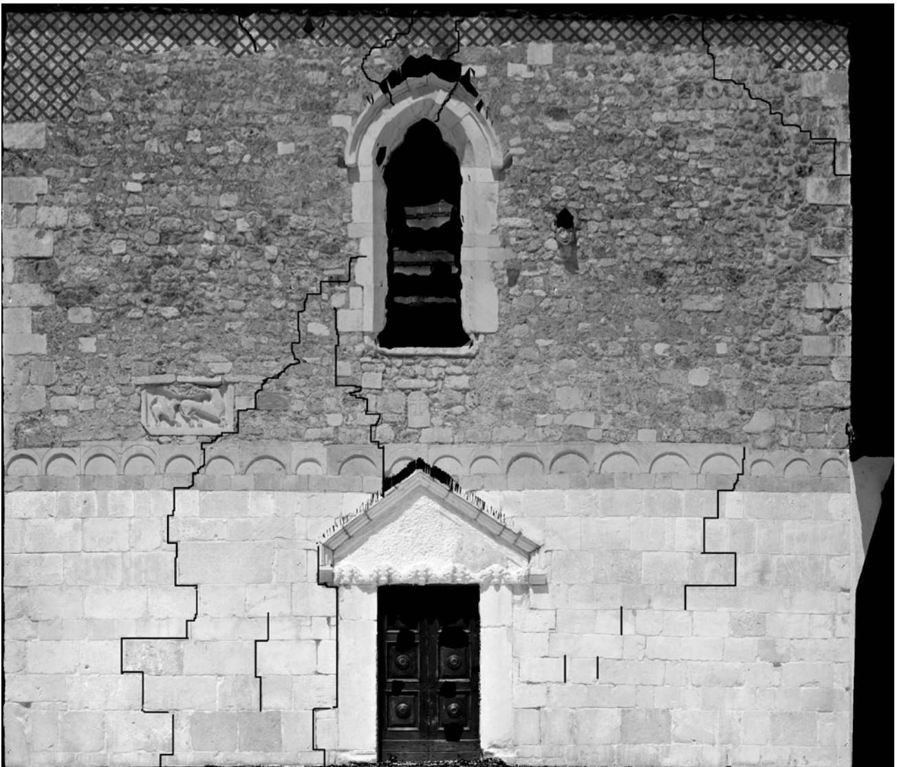
fig. 4 – Fotopiano della facciata con le lesioni e le fasi costruttive.
